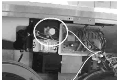
5.進行更換燈管啓動器。
